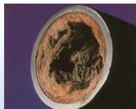
薬剤未使用の配管
